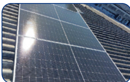
Placas fotovoltaicas no AME-PG
