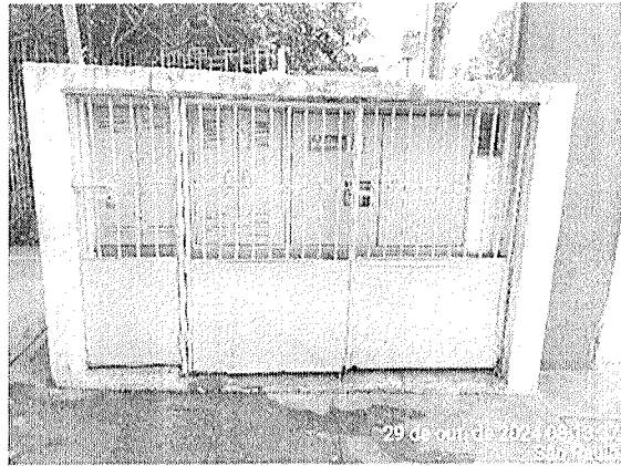
Figura 7. Padrão instalado em outra unidade.
